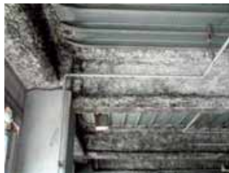
天井などに吹付けられたアスベストの例
