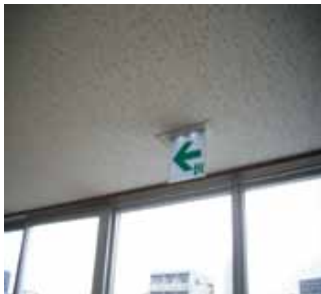
西池袋中学校 LED 誘導灯
