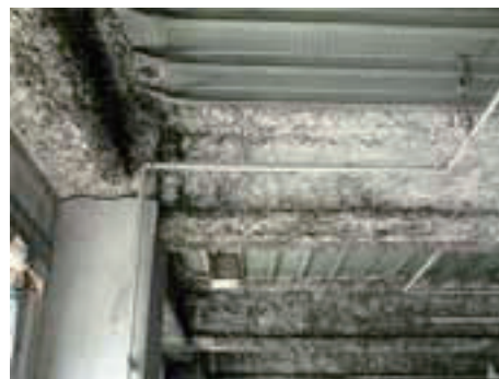
天井などに吹付けられたアスベストの例
