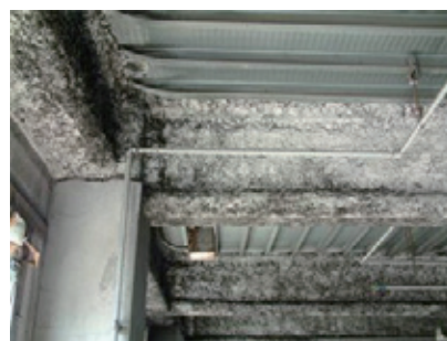
天井などに吹付けられたアスベスト
