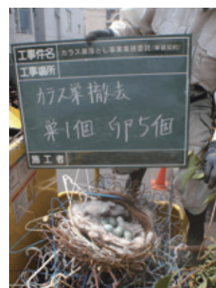
撤去したカラスの巣
