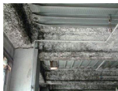
鉄骨に吹付けられたアスベスト
