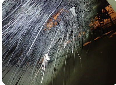
焼却炉内部に絡まった不燃物
