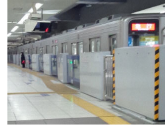
⑥ホームドアの設置状況
