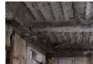
吹付けアスベスト
