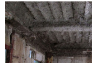
吹付けアスベスト
