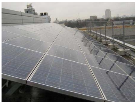
【太陽光パネル】
