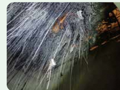
焼却炉内部に絡まった不燃物
