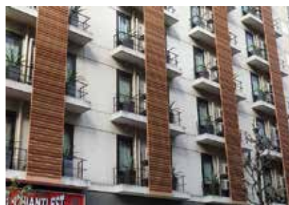
【6-④】 室外機の目隠しを壁面のアクセントとし、植栽で側面から見えにくくした例
