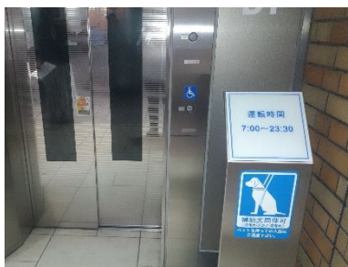
運転時間を示したエレベーター
