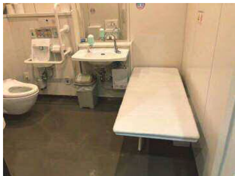
大型ベッドが設置された車椅子使用者用トイレ
