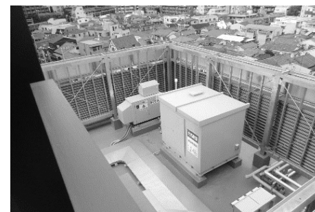
非常用発電機 (屋上) 災害停電時の使用を想定した 1 階室内の照明(50%程度)、一部コンセントに約 72 時間給電する。
