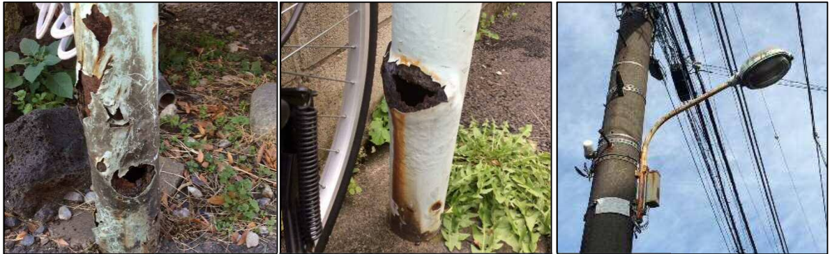
【写真】穴や錆が発生し、著しく老朽化した街路灯
