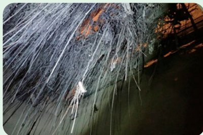
焼却炉内部に絡まった不燃物
