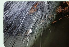
焼却炉内部に絡まった燃やさない不燃物
