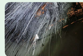
焼却炉内部に絡まった不燃物
