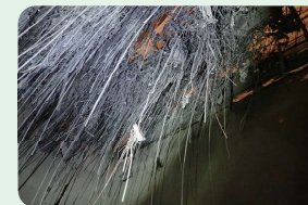
焼却炉内部に絡まった不燃物
