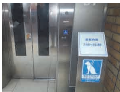
運転時間を示したエレベーター
