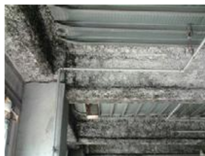
鉄骨に吹付けられたアスベスト
