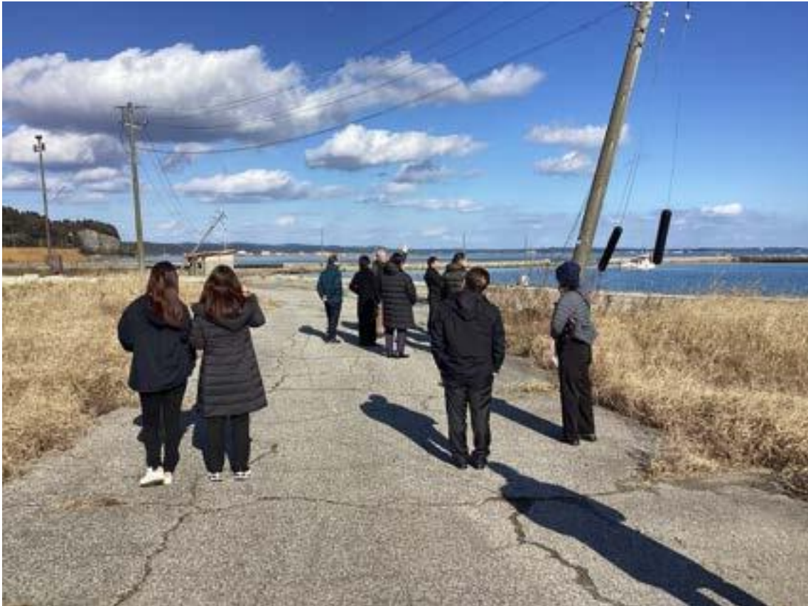
傾いたままの電柱及び道路の亀裂
