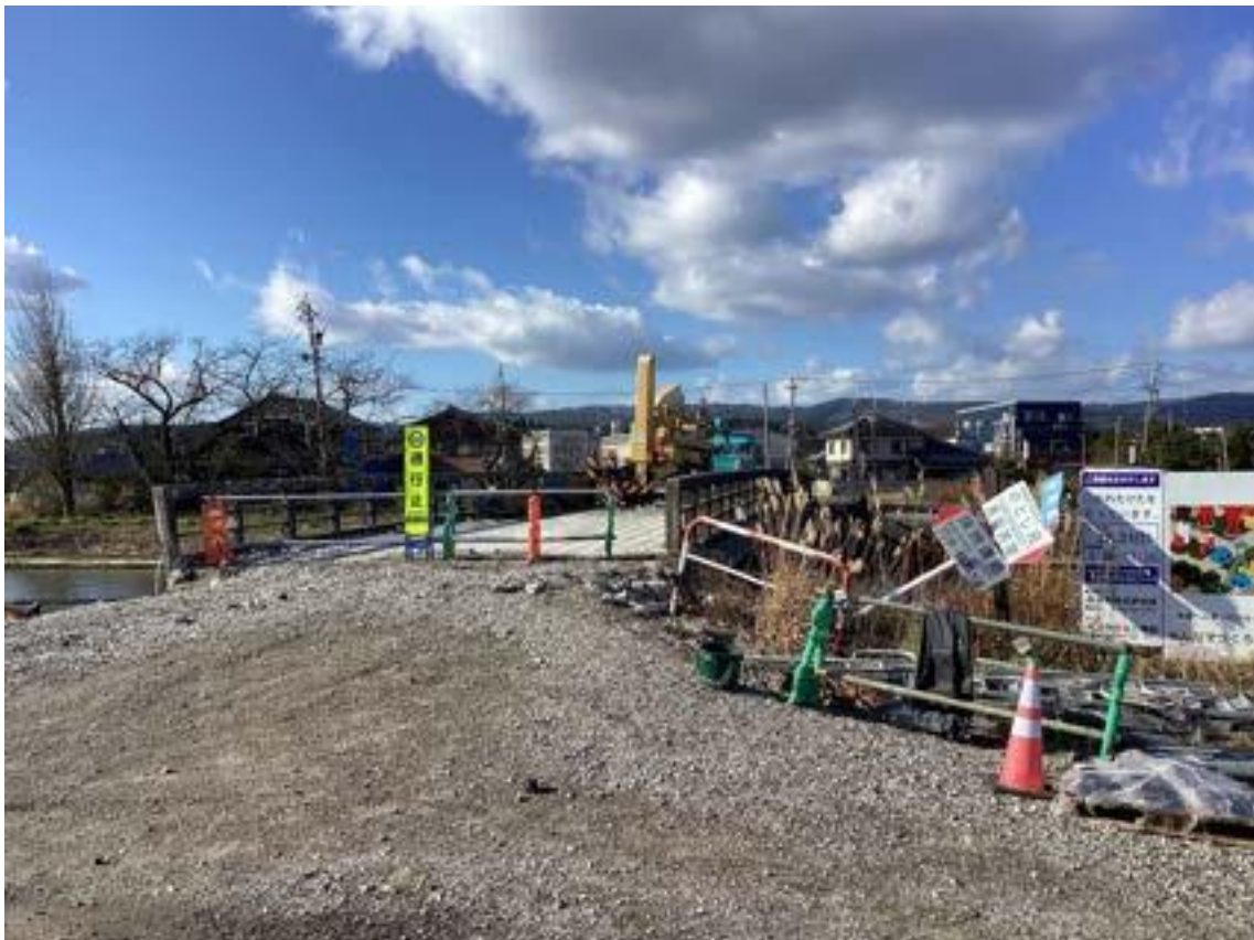
橋の横の地盤が沈下し砂利で埋められている
