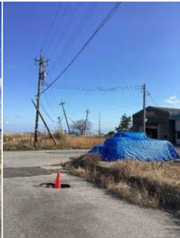
陥没した道路
