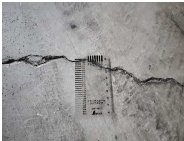
調査の様子(千川駅南自転車駐車場 床面の劣化)
