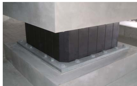
▲免震装置に組み込まれた積層ゴム支承
